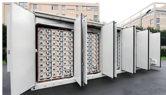
图5 传统风冷式储能电站
